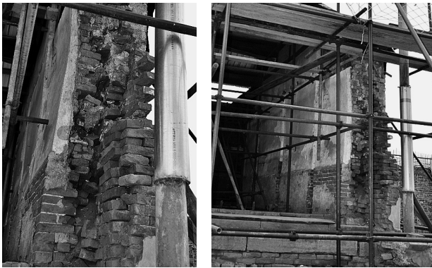
图4 东侧山墙局部塌落、歪闪倾斜，砖块松动脱落、灰缝白灰浆松散粉化
