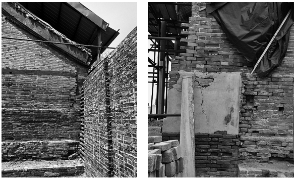
图3 东侧山墙局部存在沿灰缝竖向剪齿形开裂、砖块松动脱落
