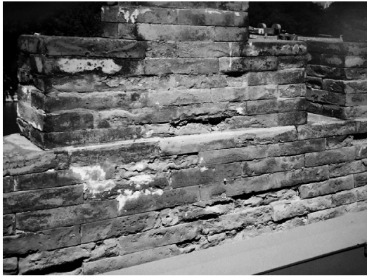
图12 磔墙残损现状
