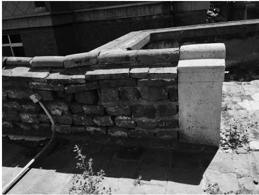
图13 宇墙残损现状
