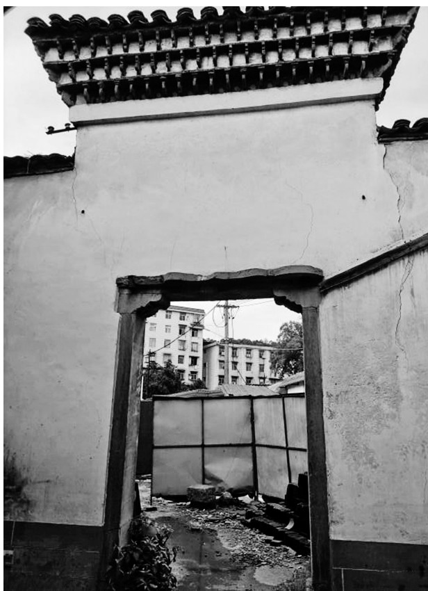
图12 花大门背面（可见右侧竖裂缝）
