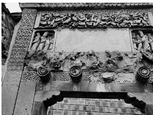
图10 门框正面（可见开裂）
