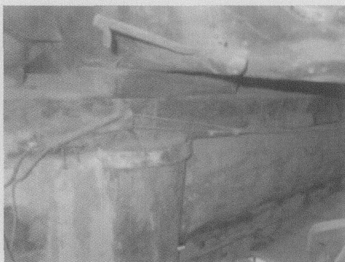
图10 戏楼改建残留灰泥及电线、铁件
