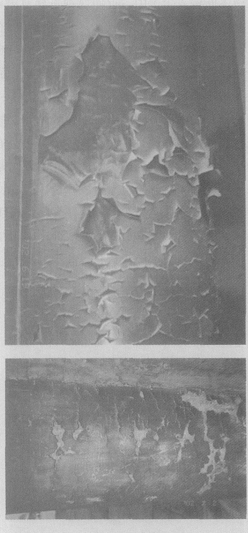
图4 下架油饰的脱落病害
