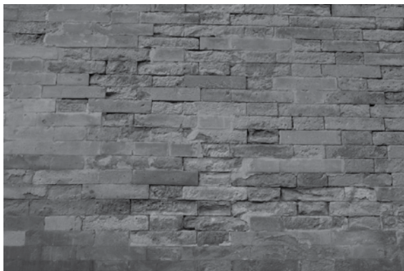
图26 西华门外城墙修复前残损情况
