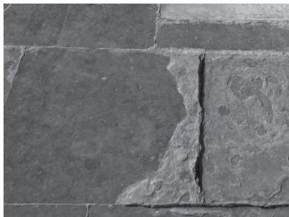
图2 地面砖小面积缺损
