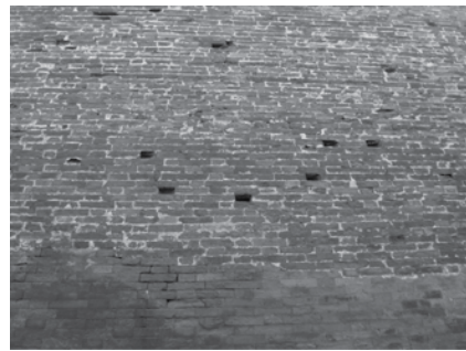
图12 午门西侧城墙丁砖残缺现状
