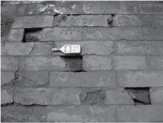
图20 修复前的衍祺门外地面砖
