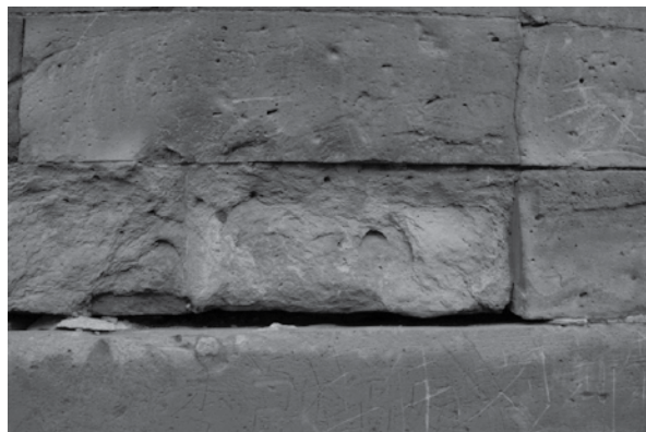
图27 西华门外城墙修复前残损情况
