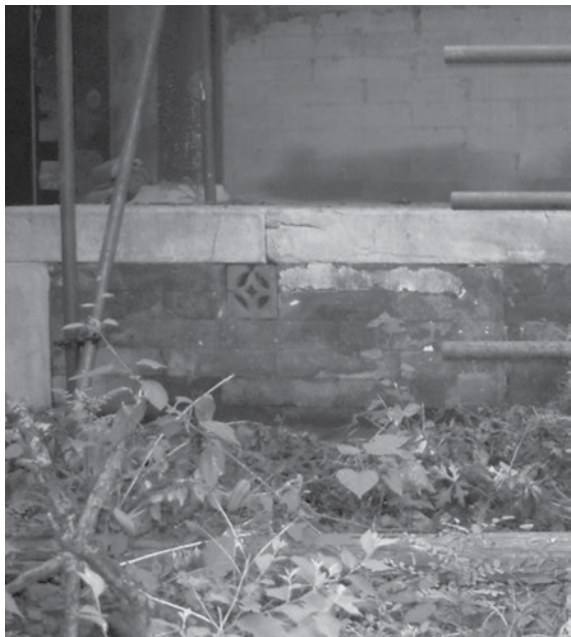
图3 英华殿西耳房西稍间前檐台帮排烟口
