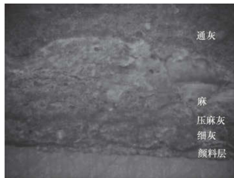
图16 启圣祠内檐西稍间前檐中金檩随檩枋海底
