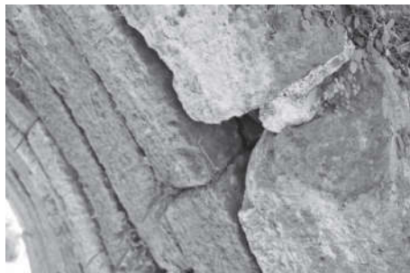
图5 临海桃渚城东城门内门拱券灰浆流失
