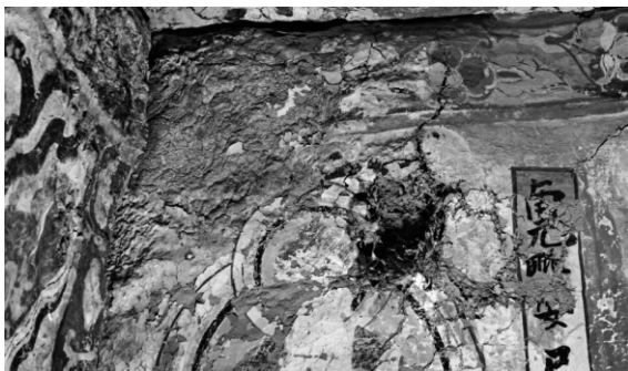
图1 第245窟东壁壁画酥碱、空鼓、盐壳病害
